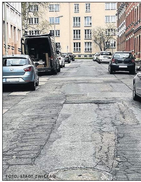
GmbH bitten um Verständnis. Bereits 2022 erfolgte die grundlegende Erneuerung der Döhnerstraße zwischen Antonstraße und Marienthaler Straße.
